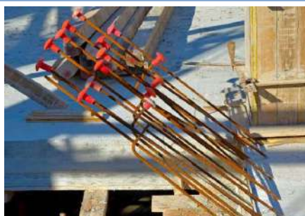
Balesetveszélyre figyelmeztető betonacél védősapka 45 fokban bekötött armatúra kiálló betonacélvégein
